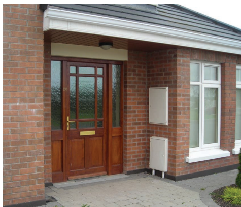
Exemple d'un compteur dans une zone qui pourrait être enfermée.
